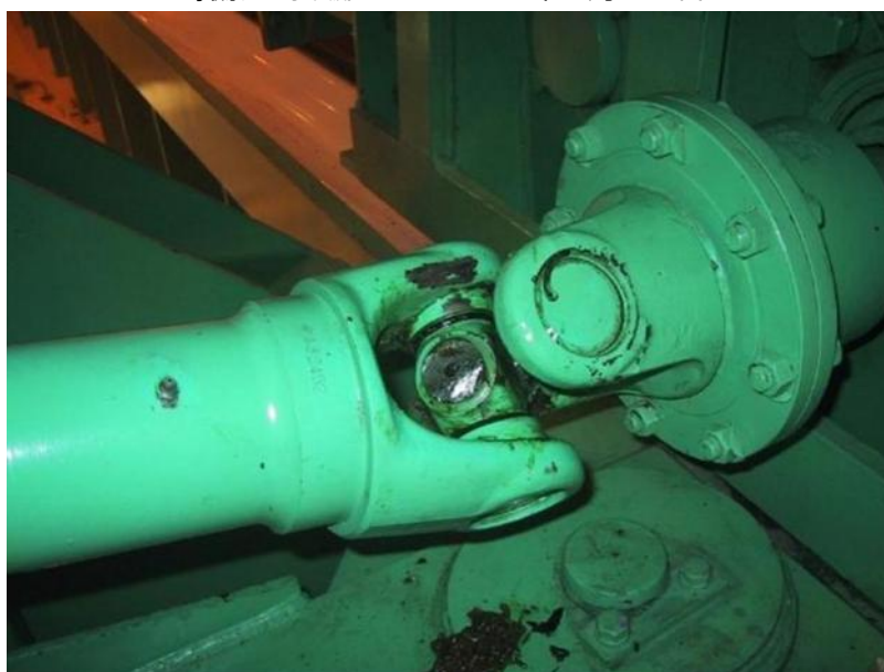
壊れた核燃料クレーンの継ぎ手
